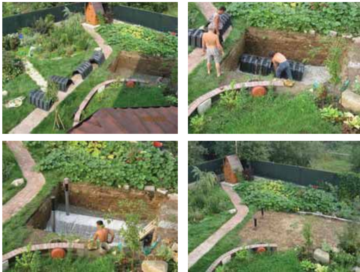
Рис. 4. Этапы строительства сооружения почвенной фильтрации бытовых стоков с использованием фильтрующих туннелей. Лето 2010 года, Подмосковье.
